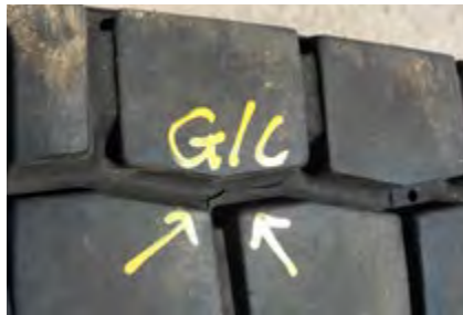
<Fissure des rainures de type 2>
