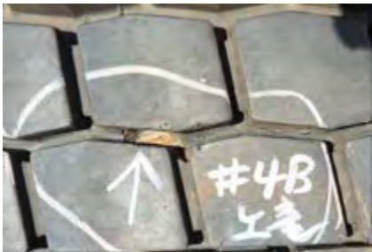
<Fissure des rainures de type 1>
